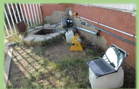
Équipement au forage S12 (école de Balaruc)
